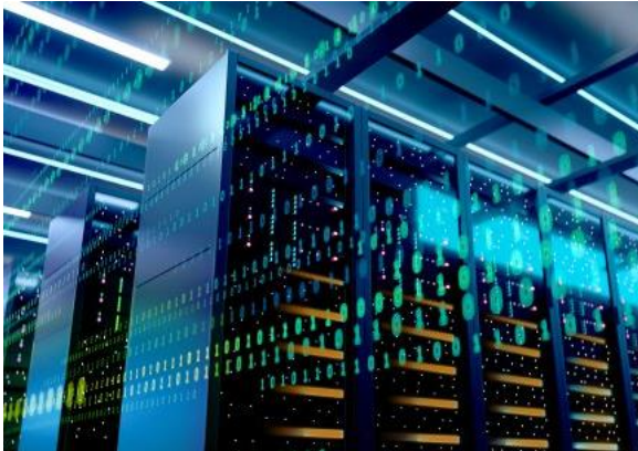
DATA CENTER AI
